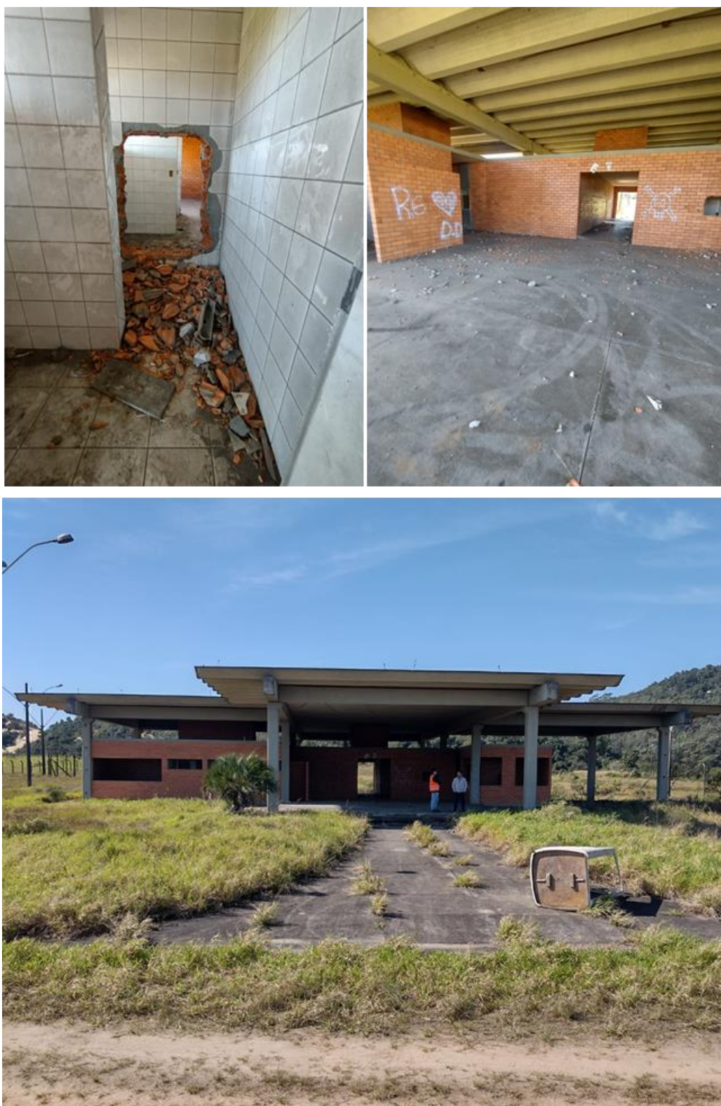
Figura 8: Edificação 6 – Situação atual do imóvel.
