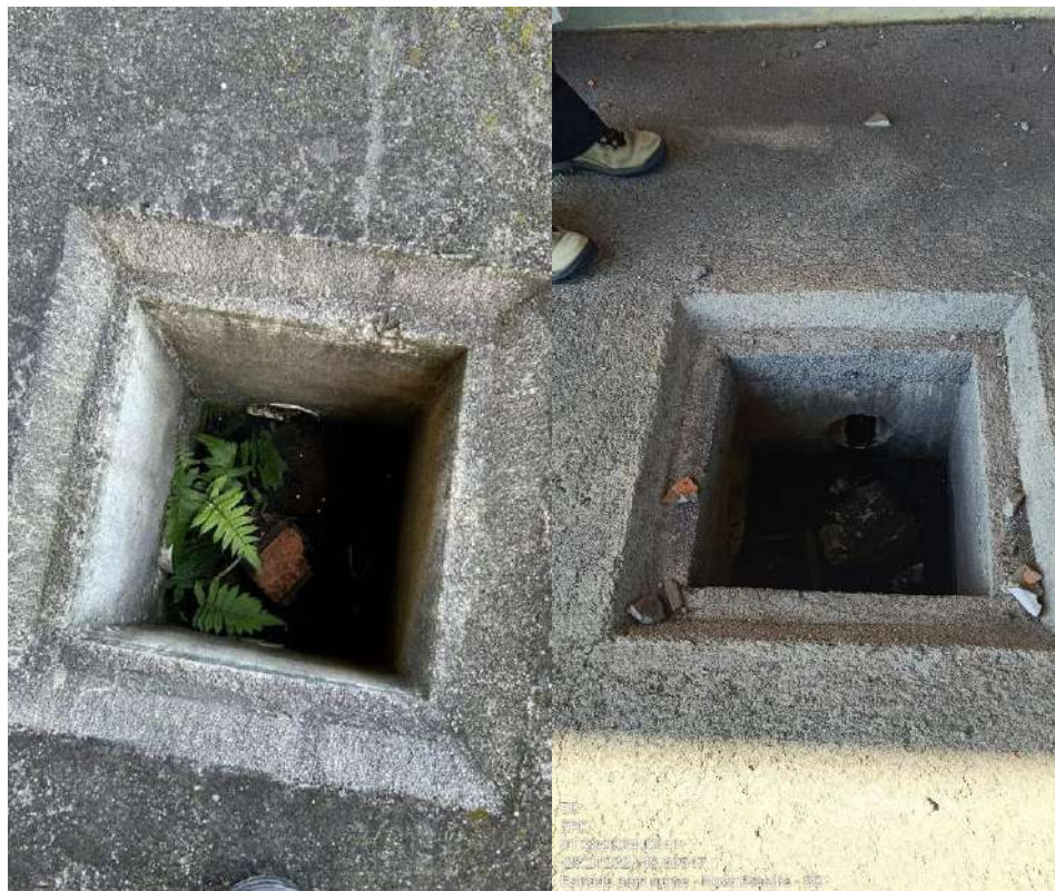
Figura 9: Fossa séptica de uma edificação.
