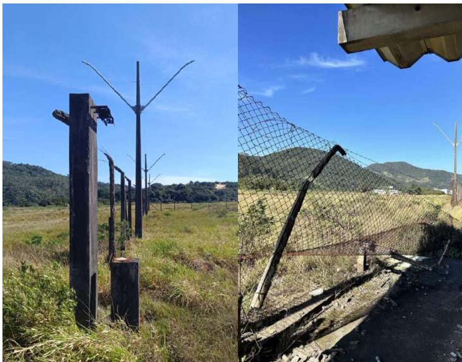
Figura 10: Cercamento e postes comprometidos na área do terreno.
