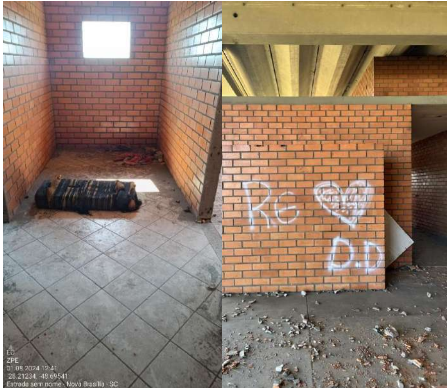
Figura 8. Colchão e pichação encontrados dentro das edificações.
